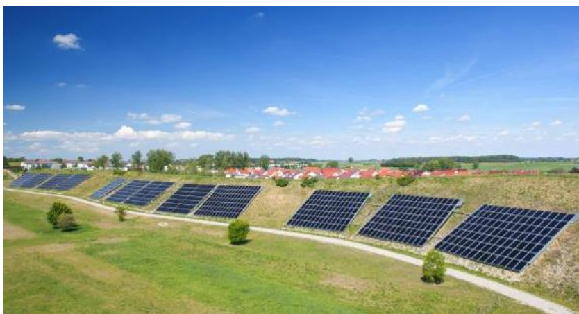
Abbildung 4-4 Freiflächen-Solarthermieranlage in Crailsheim (Quelle: www.sonnewindwaerme.de/solarthermie/solare-waermenetze-baden-wuerttemberg )
